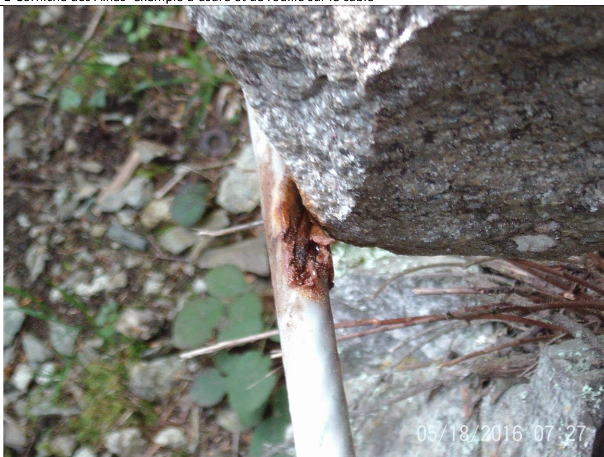
2- Corniche des Alhas- exemple d'usure et de rouille sur le câble
