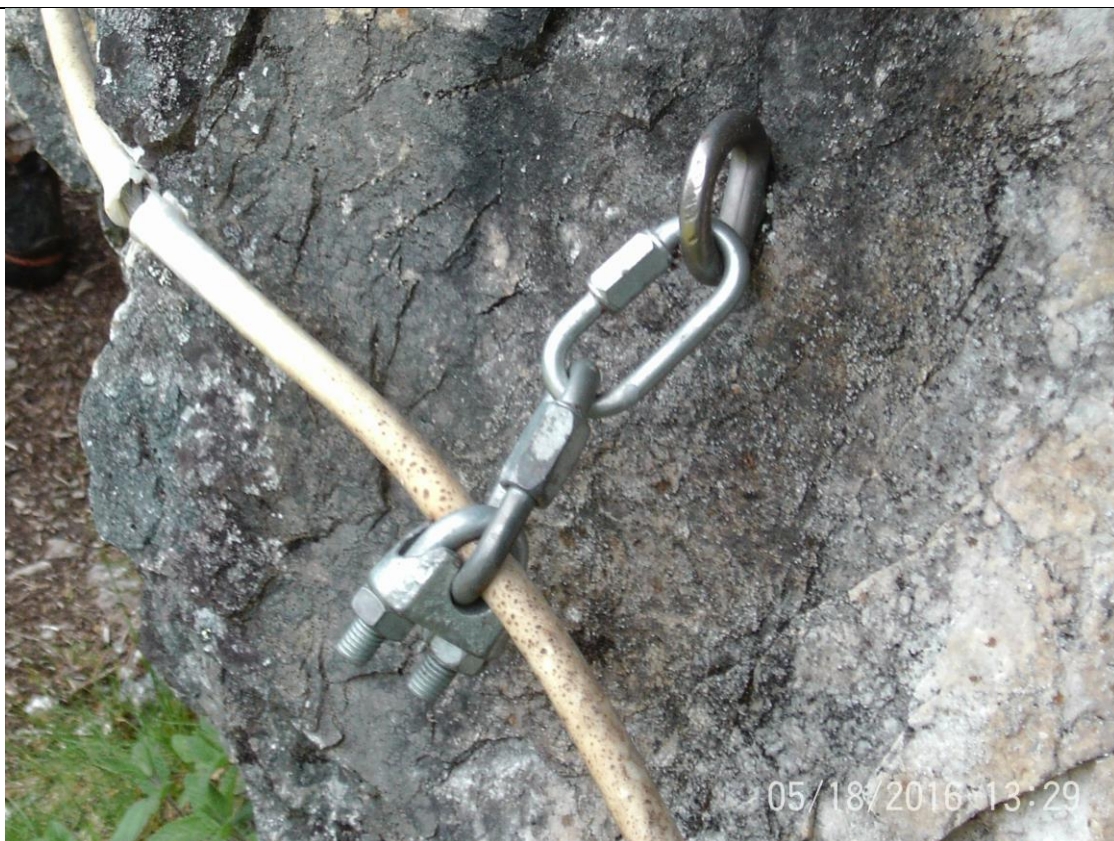
3- Etat des attaches du câble de la corniche des Alhas
