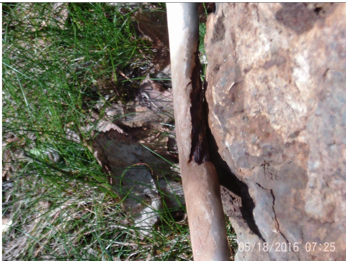
1-Corniche des Alhas- exemple d'usure et de rouille sur le câble
